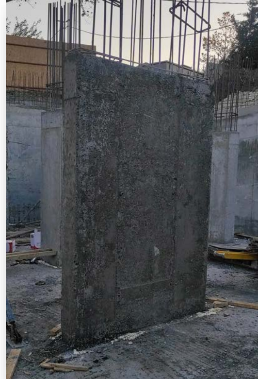
Beton harcından kaynaklı problem
