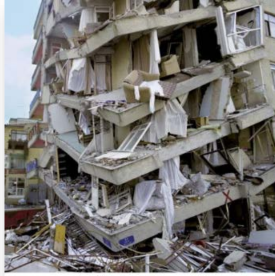
Köşe kolon hasarı
