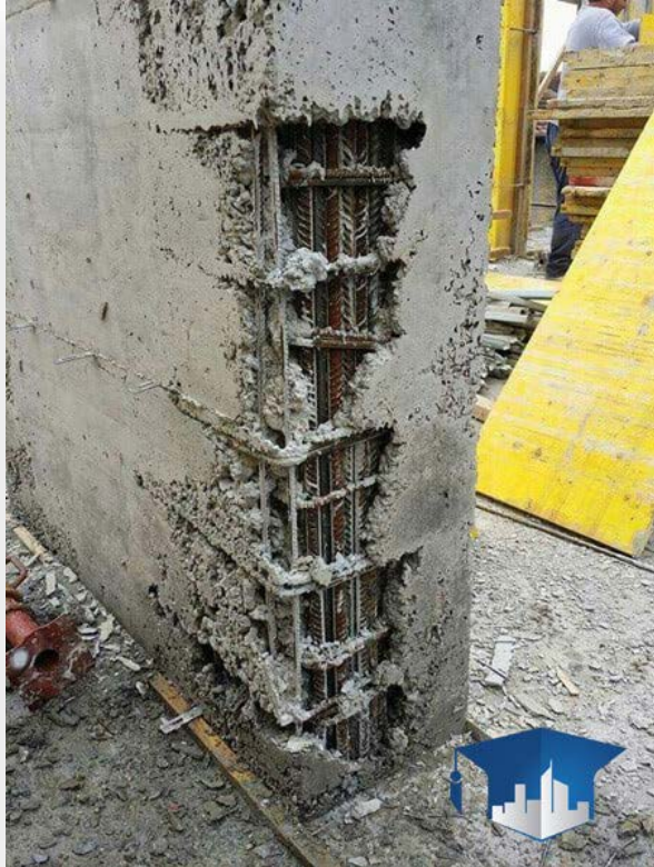
Yetersiz vibratör uygulaması
